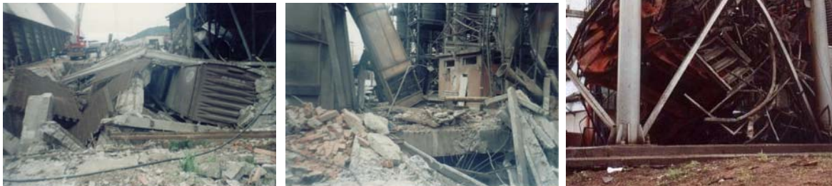
Explosões recentes causadas por poeiras de cereais, neste caso os danos provocados foram aos pavilhões, aos equipamentos de beneficiamento e aos elementos transportadores, o que evidencia que a explosão iniciou dentro internamente, ganhando propagação e aumentando seus efeitos até atingir os pavilhões que foram os finais.
